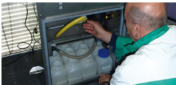
Abb. 1: Installation des automatischen Probennehmers – das Abwasser kann vom Kanal zu diesem hinaufgepumpt werden
